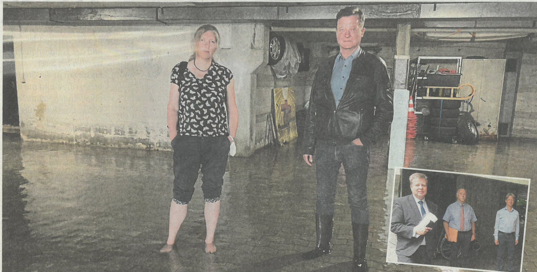
Franziska von Gagern und ein Unterstützer der ersten Stunde: Der Landtagsabgeordnete Christian Hierneis (Grüne) in der Tiefgarage der Genter Straße. Kleines Bild, weitere politische Unterstützung für die Grundwasser-Opfer: (v.l.) Landtagsabgeordneter Robert Brannekämper (CSU) und Benno Zierer (FW), sowie der Anwalt der Anwohner Benno Ziegler. Fotos: Hüseyin Ince, Daniel von Loeper
