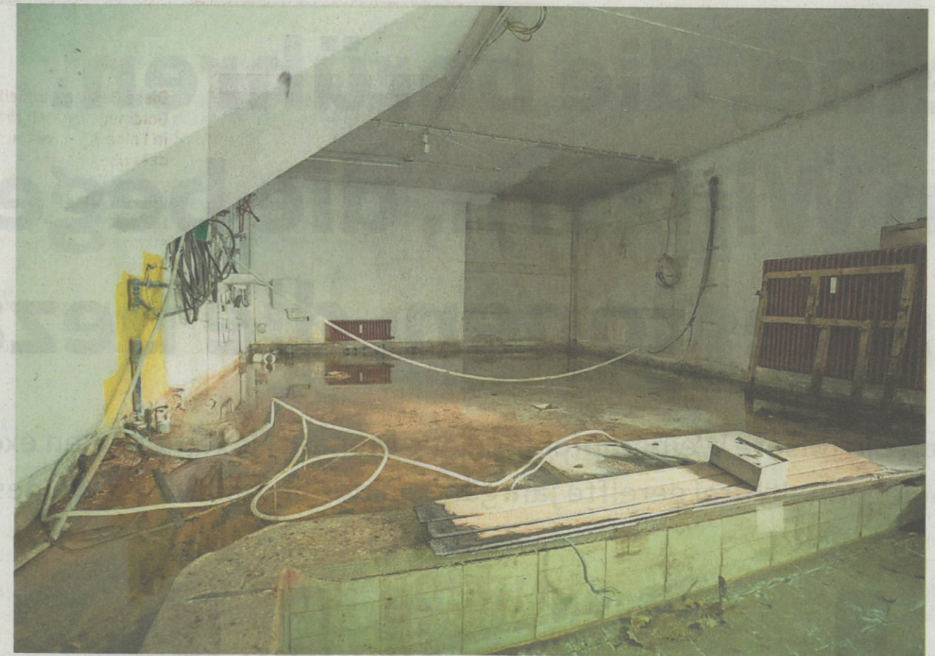
In den Kellern der Anwohner in Schwabing steht das Grundwasser.
