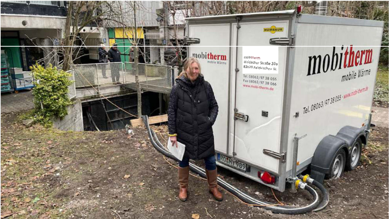
Die Haus-Heizung ist vom Wasser zerstört worden. Franziska von Gagern steht vor einem mobilen Heiz-Anhänger, der das Gebäude mit Wärme versorgt
