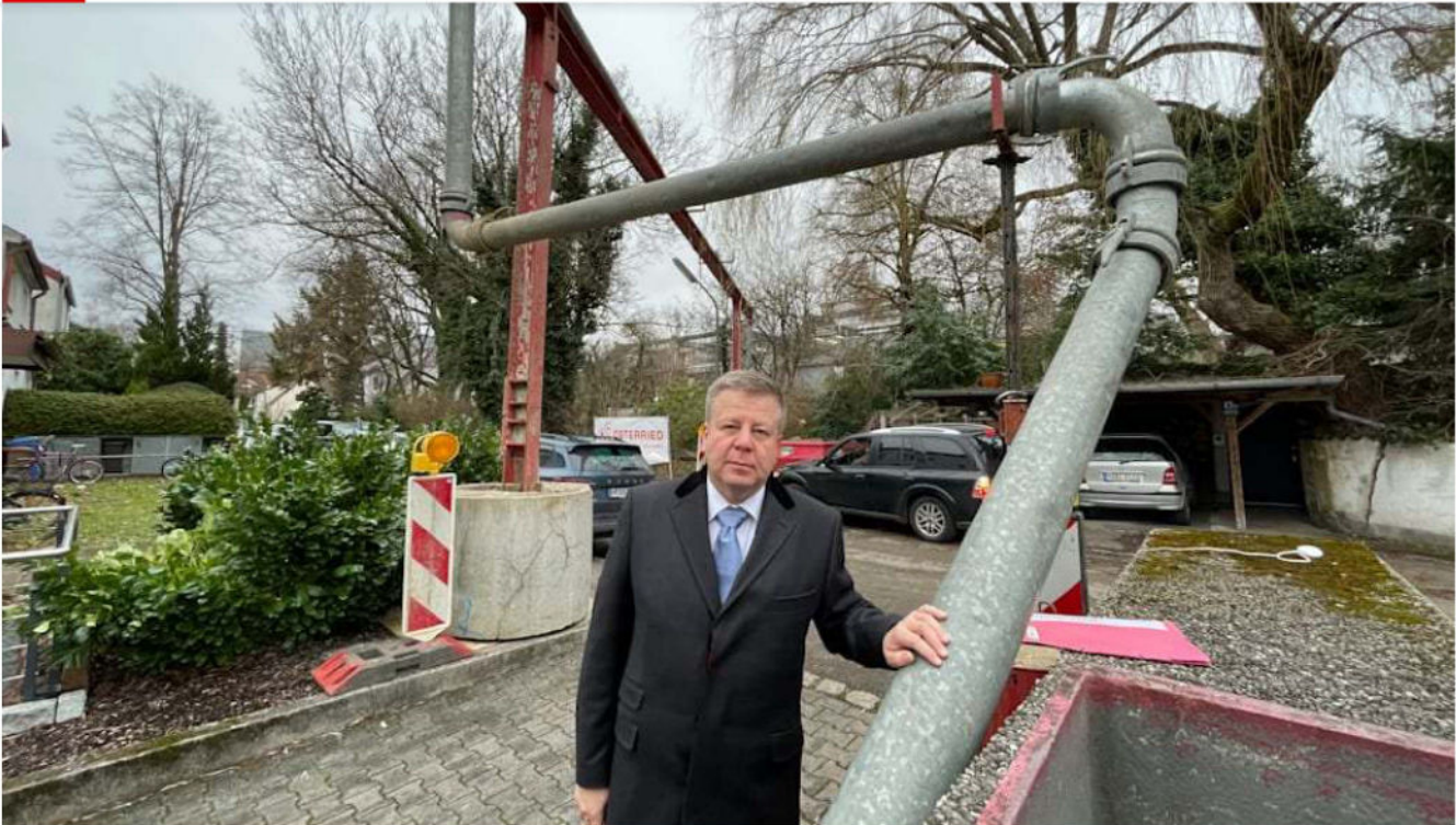
Landtagsabgeordneter Robert Brannekämper (CSU) vor den Rohren, die jetzt das Wasser aus den Häusern über die Genter Straße zum nahegelegenen Bach „Schwarze Lacke“ leiten.
